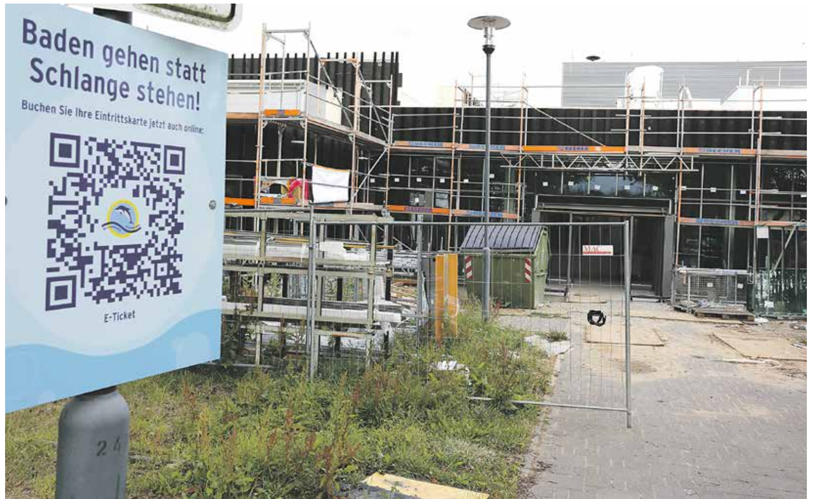
Hier kann aktuell niemand baden gehen. Durch einen Vergabefehler der Verwaltung verzögert sich der Bau um mehrere Monate.
