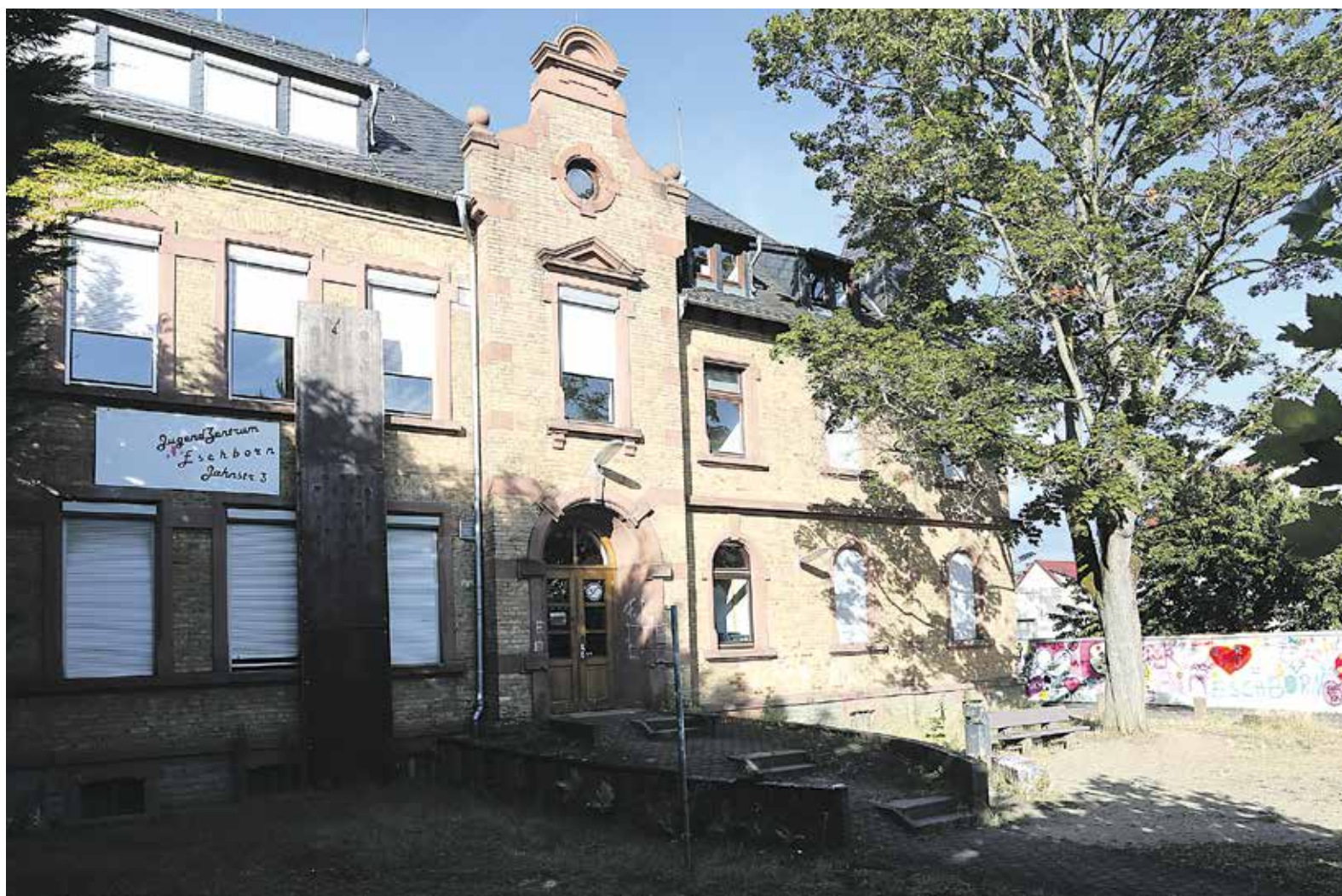
Das alte Jugendzentrum muss endlich saniert und den Vereinen zur Verfügung gestellt werden!
