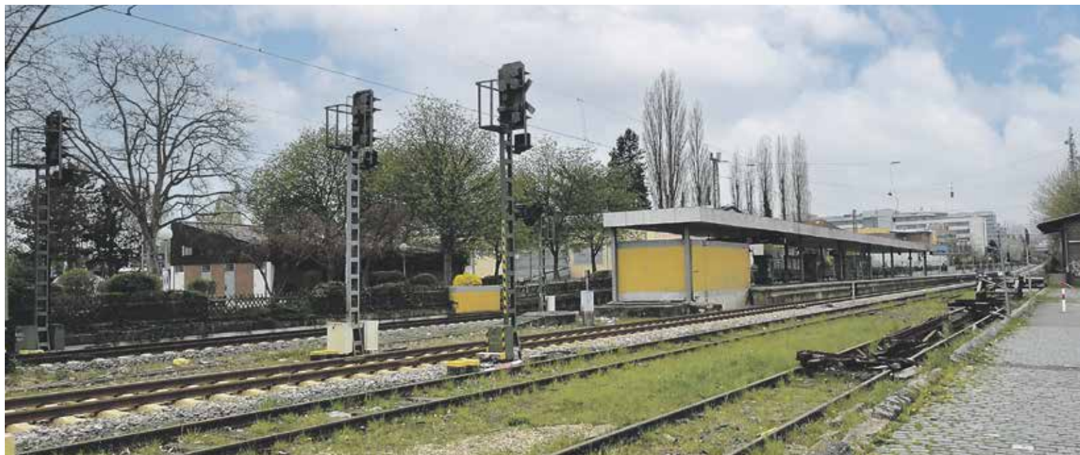
Der Bahnhof Eschborn Mitte muss endlich saniert werden!
